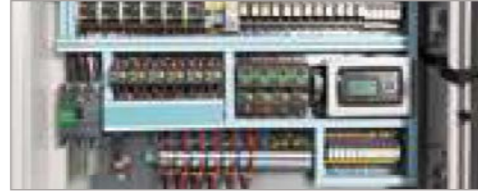
• Kolay ulaşılan elektrik paneli
